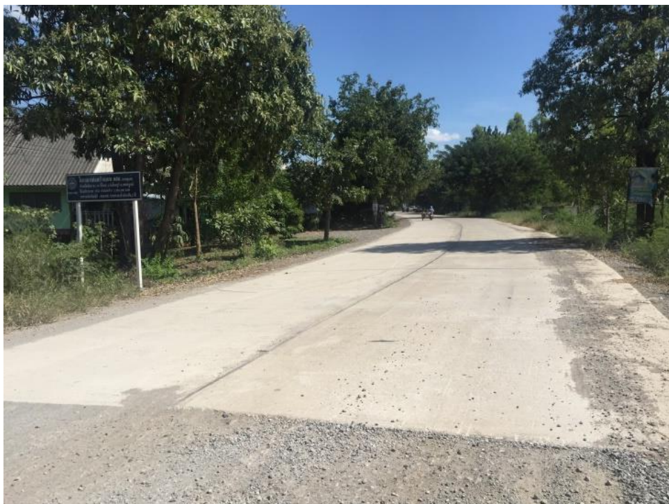
ก่อสร้างถนน คสล. สายพุดเตย - บ้านซับน้อย หมู่ที่ ๑ ตำบลวังใหญ่ อำเภอวิเชียรบุรี จังหวัดเพชรบูรณ์
